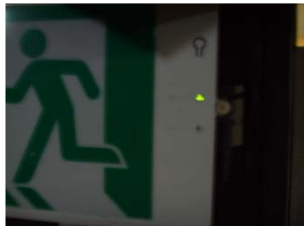
〈그림 108〉 피난구 유도등 점검스위치 및 전원감시등
