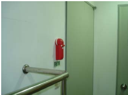
〈그림 111〉 휴대용 비상조명등 설치
